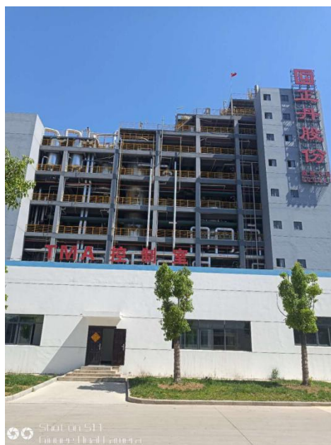
新建区 TMA 装置区
