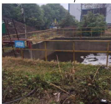
污水处理总排放口
