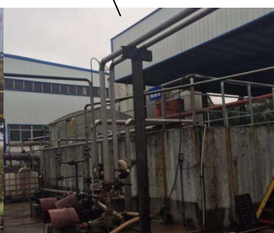
污水处理装置
